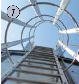
1 ÉCHELLE DE TOIT
