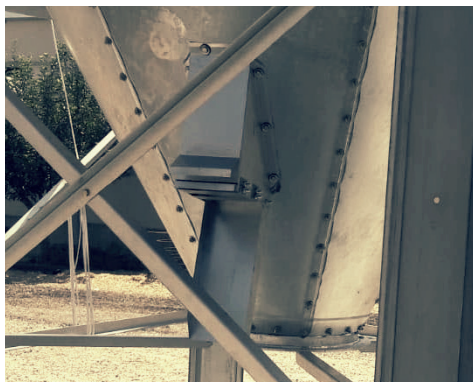
BOQUILLA AUXILIAR EN TOLVA
