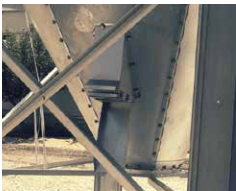
BOQUILLA AUXILIAR EN TOLVA
